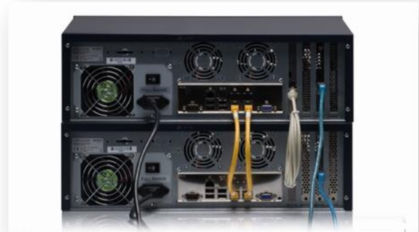
Abbildung 7: Verkabelung der Collax V-Bien Appliance
